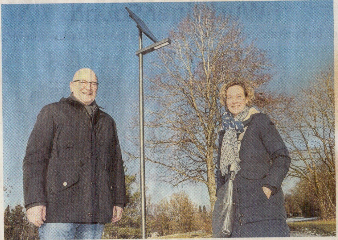
Unabhängig vom Stromnetz: Kraillings Bürgermeister Rudolph Haux und Silke Mall von den Bayernwerken bei der ersten Solar-Straßenlaterne Kraillings. FOTO: DAGMAR RUTT
